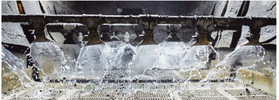
Bei der afu sind große Mengen Prozesswasser im Umlauf – hier beim 8-Millimeter-Sieb für das Überkorn.
